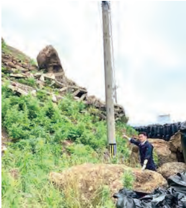
土砂崩れの現場の下には土嚢袋が置かれただけの対応
