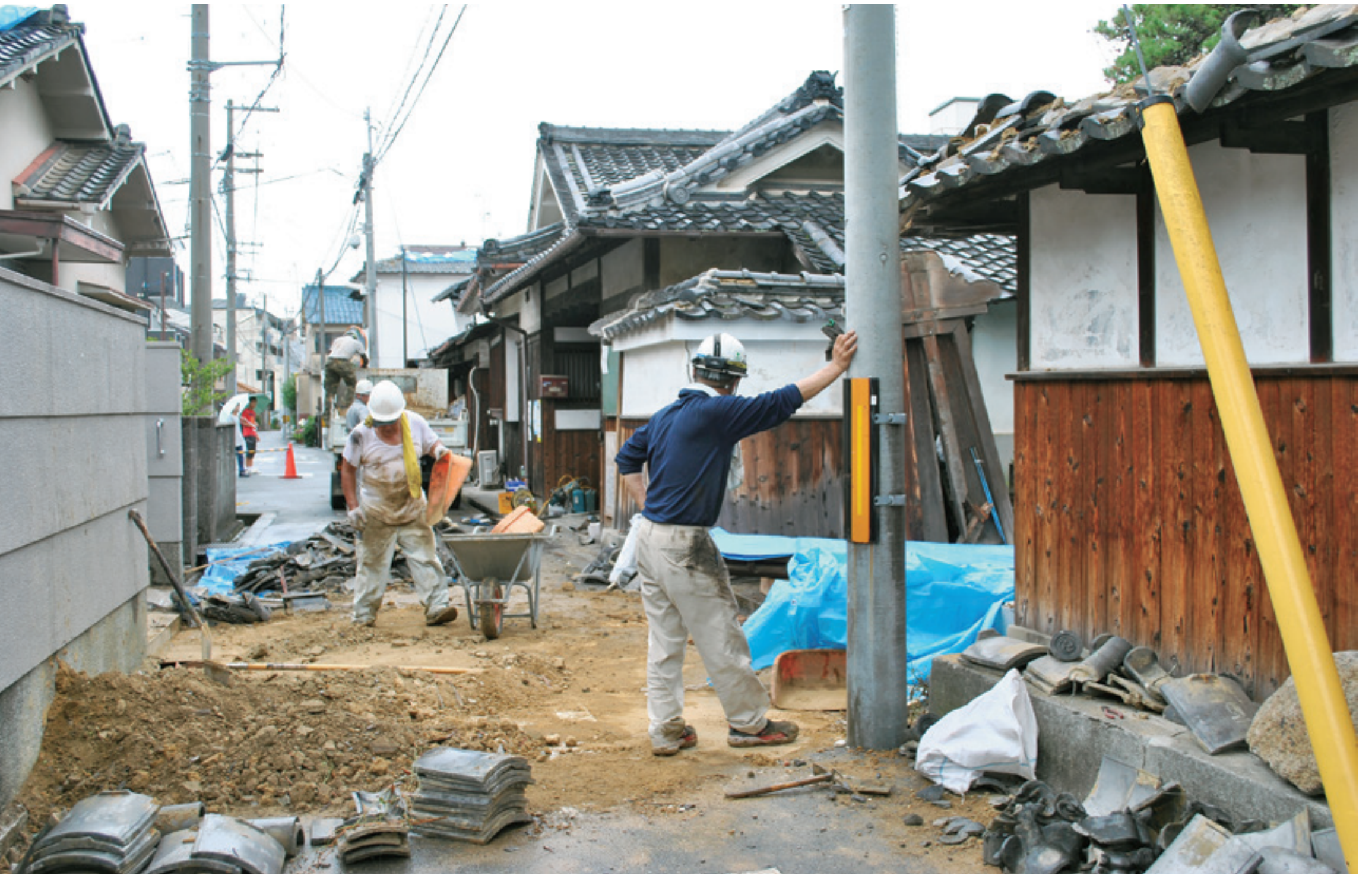
大きく被害を受けた住宅=6月19日、大阪府茨木市
