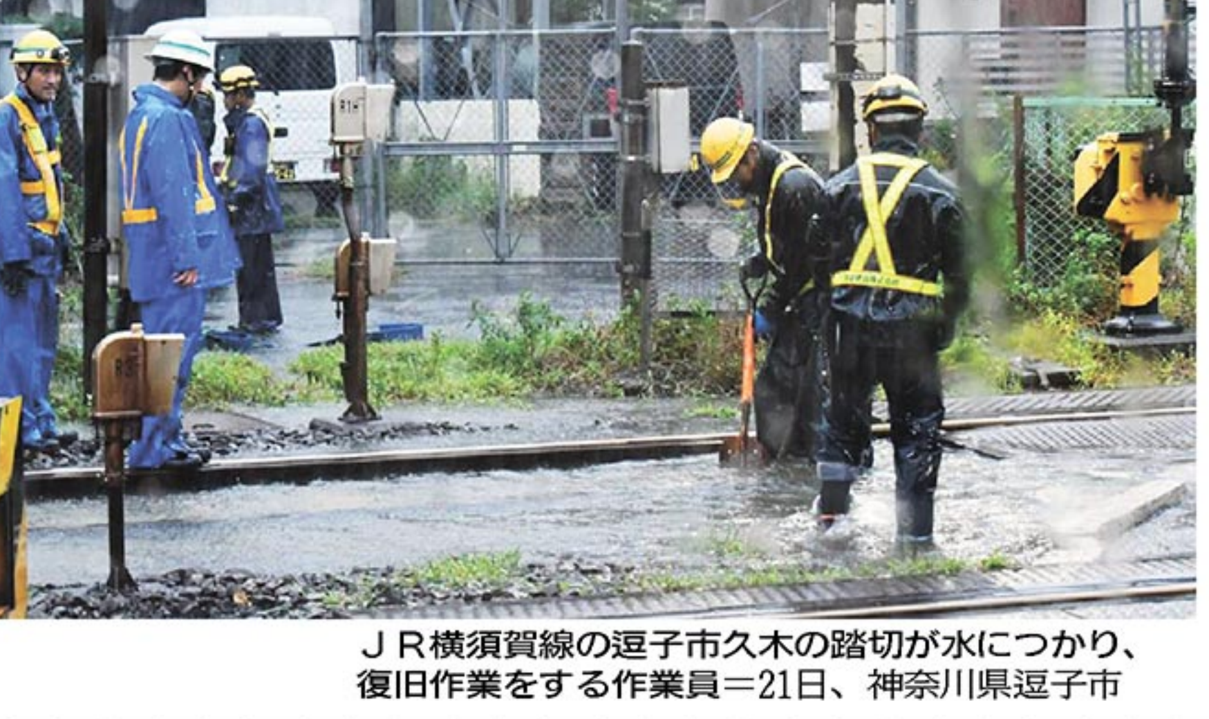
JR横須賀線の逗子市久木の踏切が水につかり、復旧作業をする作業員=21日、神奈川県逗子市
